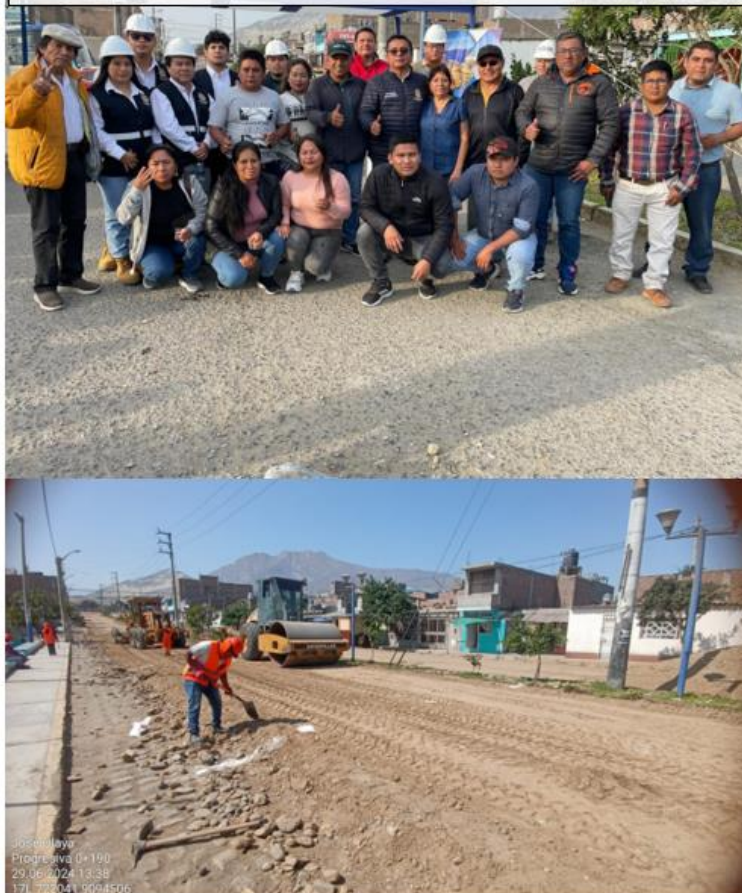
Figura 3: ejecución de la Obra REPARACION DE PISTA; EN EL(LA) AVENIDA JOSÉ OLAYA DESDE LA PANAMERICANA NORTE HASTA LA CALLE JESÚS DE NAZARETH EN ALTO SALAVERRY DISTRITO DE SALAVERRY,
