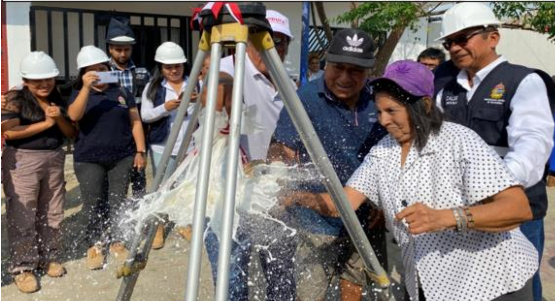
Figura 1: Ejecución de la Obra MEJORAMIENTO DE LA TRANSITABILIDAD VIAL Y PEATONAL DE LAS CALLES ALFREDO TELLO, CALLE SPELUCIN, CALLE CARLOS MANUEL COX, CALLE MANUEL SEOANE, CALLE ANTENOR ORREGO, CALLE MANUEL AREVALO, DEL AAHH AURORA DIAZ, DISTRITO DE SALAVERRY - PROVINCIA DE TRUJILLO - DEPARTAMENTO DE LA LIBERTAD.
